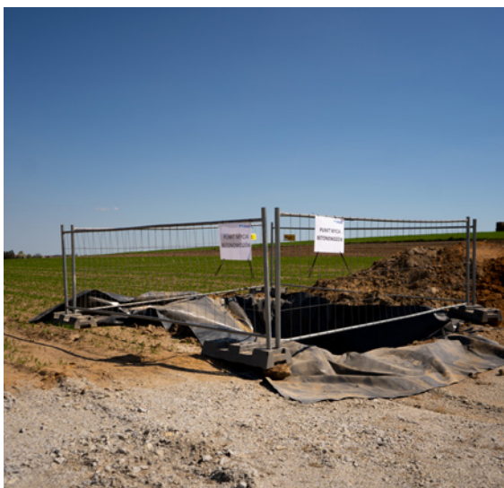
Przykład organizacji miejsca do mycia betonowozów
