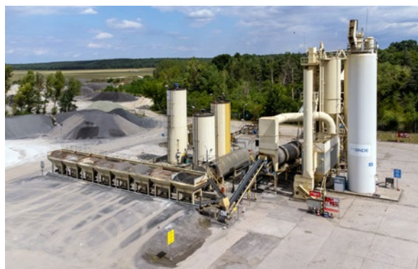
Wytwórnia Mas Bitumicznych ONDE S.A. w Toruniu
