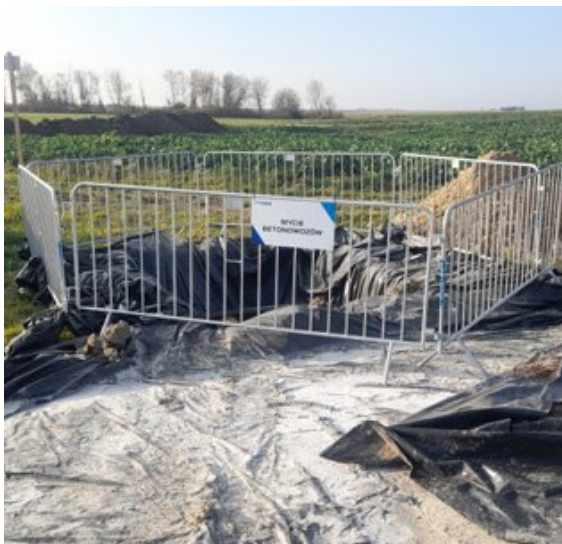
Przykład organizacji miejsca do mycia betonowozów
